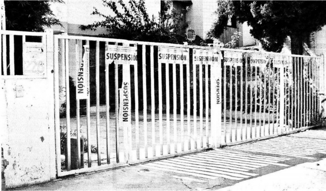
> Desarrollo Urbano de Tlalne colocó sellos de clausura en una casa que era demolida para hacer un acceso,
