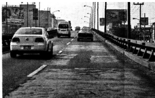
» Los puentes de Gustavo Baz, en el tramo de Tlalnepantla, presentan las mayores fallas.
