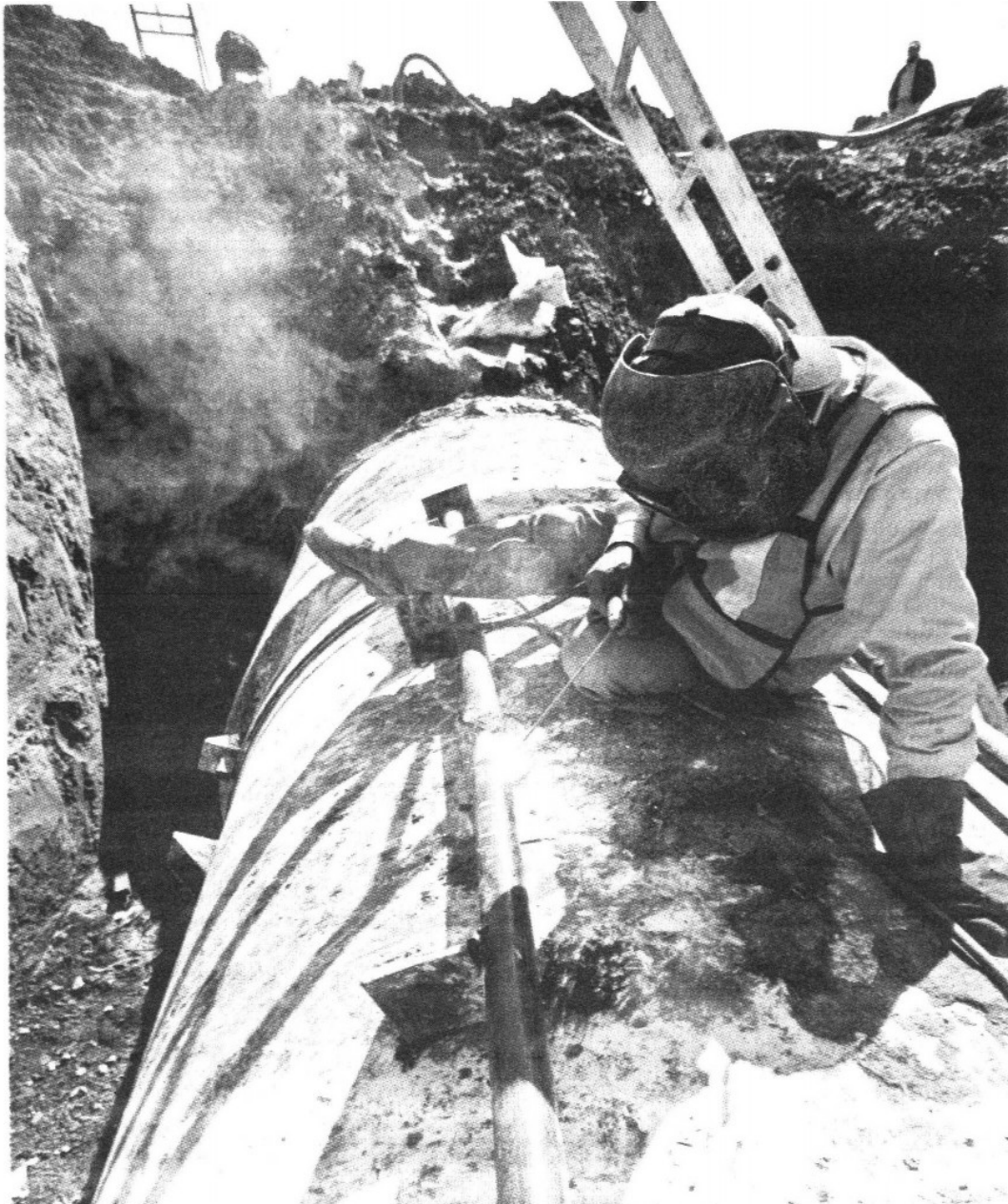
> El viernes por la tarde se concluyeron los trabajos en la tubería del Sistema Cutzamala.
