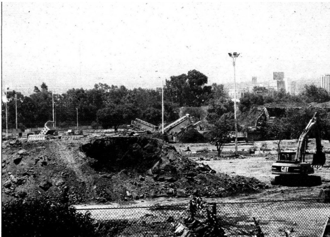
Aspecto de los trabajos de remoción de tierra en la ex refinería de Azcapotzalco ■ Foto Agustín Salgado
