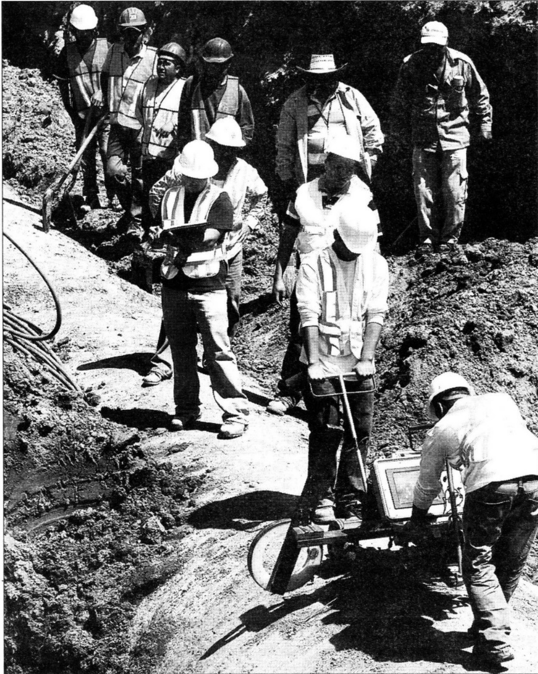
Durante los trabajos de la Conagua, el mes anterior, en un tramo de la línea uno del Sistema Cutzamala conocido como El Hospital, en el municipio Villa Victoria, estado de México ■ Foto Francisco Olvera
