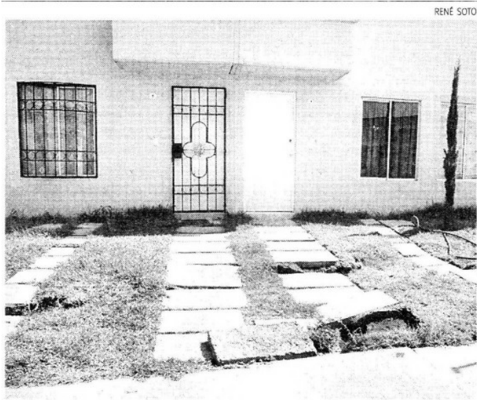
Efecto del hundimiento en las viviendas
