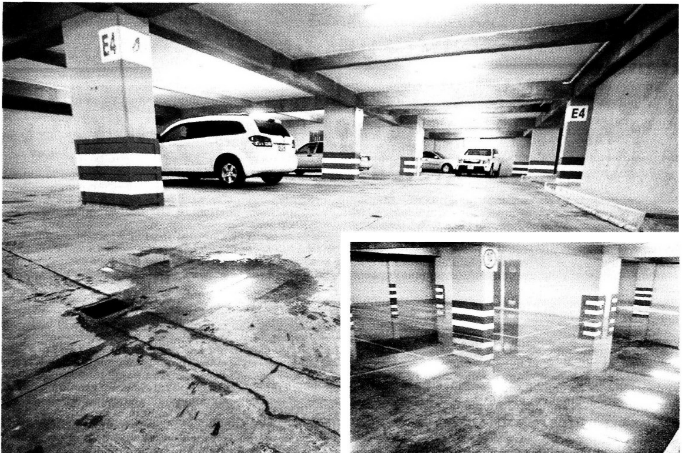
> Los residentes achacan a una fuga de agua sin arreglar las constantes inundaciones en su estacionamiento subterráneo.
