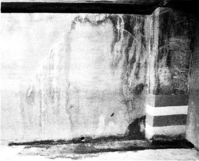
> El cuarto nivel del estacionamiento del edificio ubicado en Fuente de Molinos 30, en Tecamachalco, sufre de filtraciones y se inunda.
