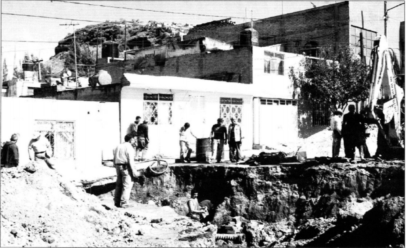
Un estudio de la mecánica de suelo descubrió un centenar de grietas y hundimientos diferenciales causados por la sobre explotación de recursos acuíferos.
