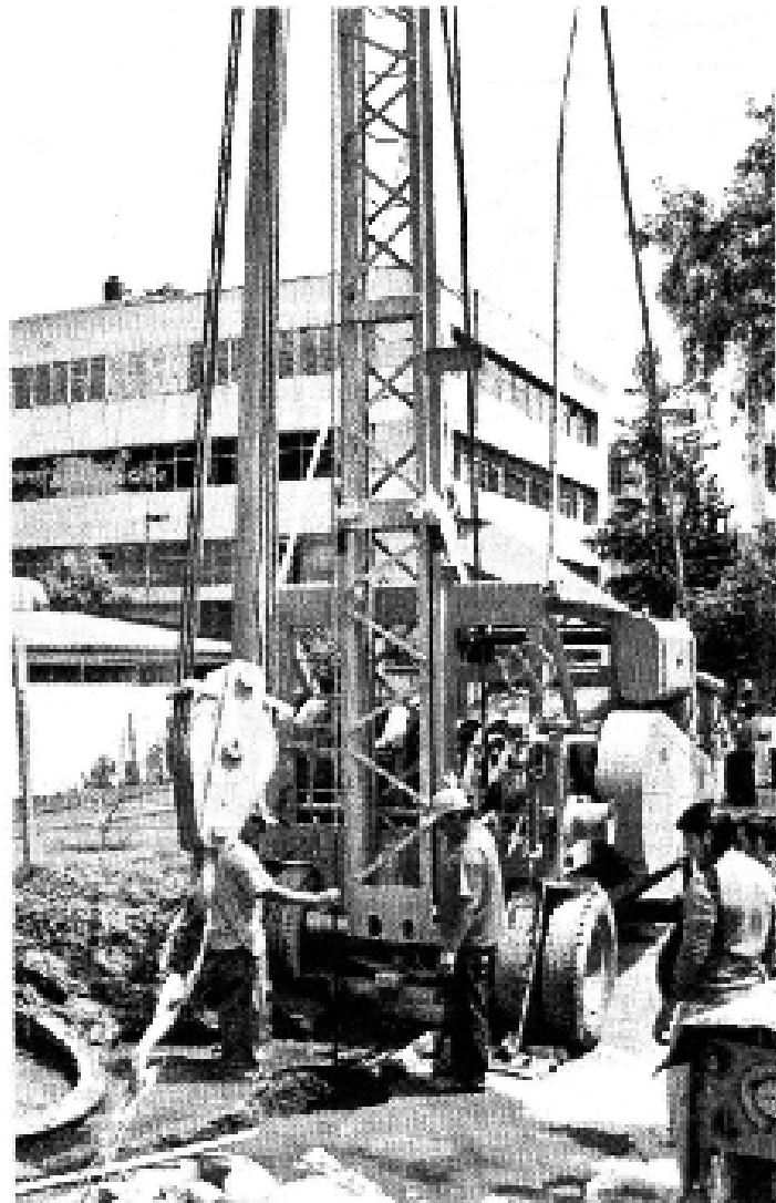
Se espera que a finales de septiembre concluya la construcción del pozo , obra que requirió una inversión de 5 millones de pesos.
