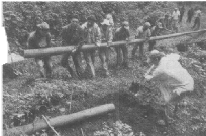
Personal de la Comisión Estatal del Agua y Medio Ambiente (CEAMA), custodiado por policías estatales, comenzó a reparar la tubería dañada.
