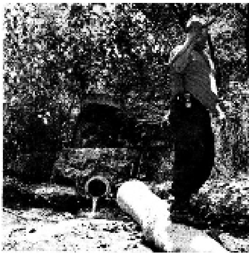
La carga de material ya destruyó los tubos del drenaje en la Barranca del Carmen
