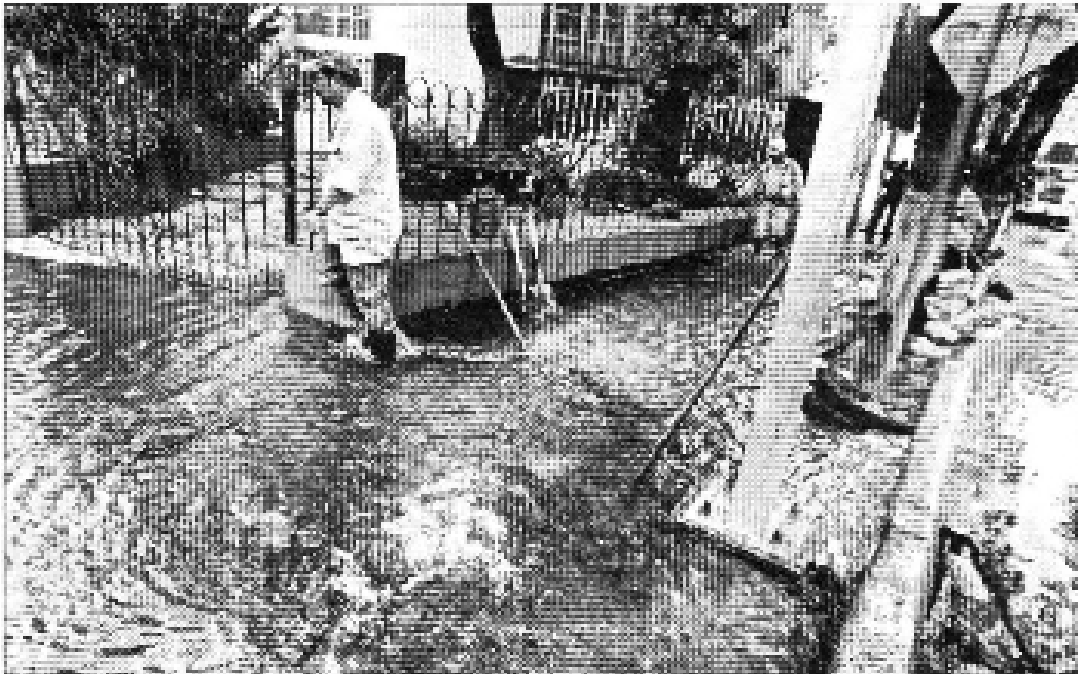
Más de cinco horas dedicaron trabajadores del IODF para controlar una fuga de agua potable en la avenida Mariano Escobedo, en la colonia Anáhuac ■ Foto: Alfredo Domínguez
