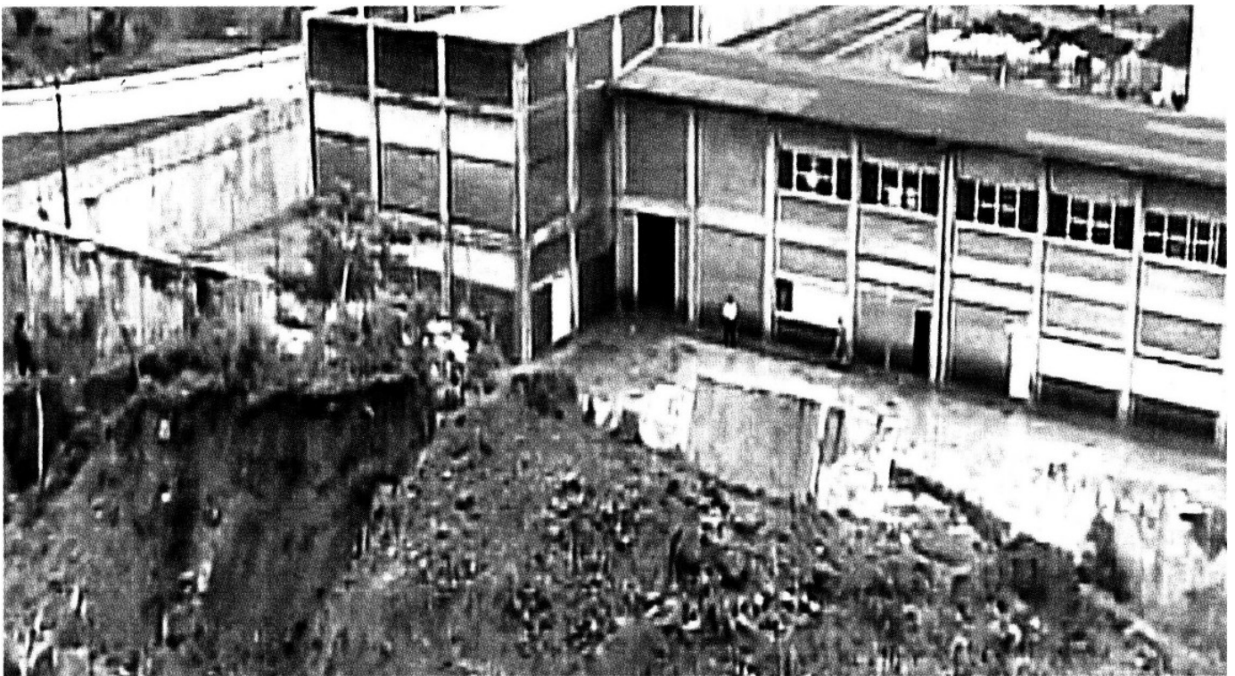
EN ALERTA. Un muro del penal de mediana seguridad conocido como La Lima, ubicado en el Municipio de Jaltocán, Hidalgo, se colapsó tras el deslizamiento de un cerro.
