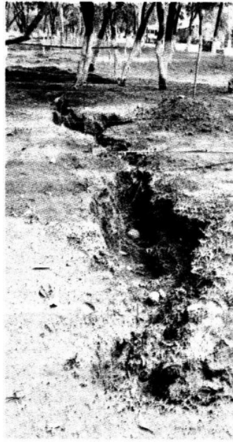
» En el camellón de Parque de Los Niños, en Arboledas, las grietas marcan el paso del Emisor.
