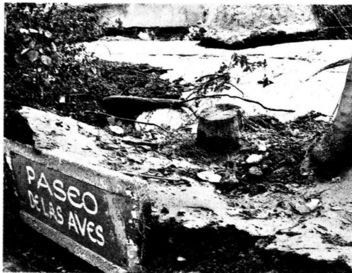
> En Paseo de las Aves se observan tramos del ducto que están descubiertos.
