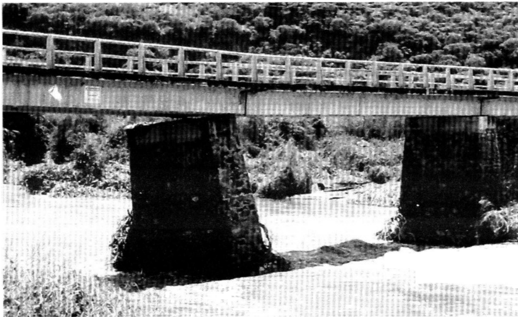
El puente que sirve de vía de comunicación sufrió severos daños.
