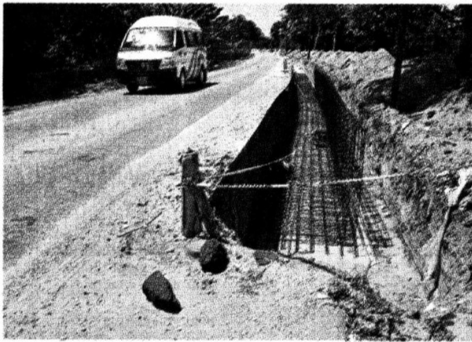
AGOSTO 20. Debido a la falta de operación política para reubicar a familias, las autoridades no han podido terminar los bordos.
