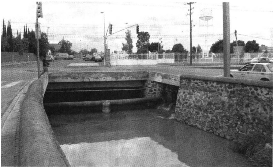
FALTAN OBRAS. La capital queretana cuenta con drenes, pero no con un sistema de recuperación de agua
