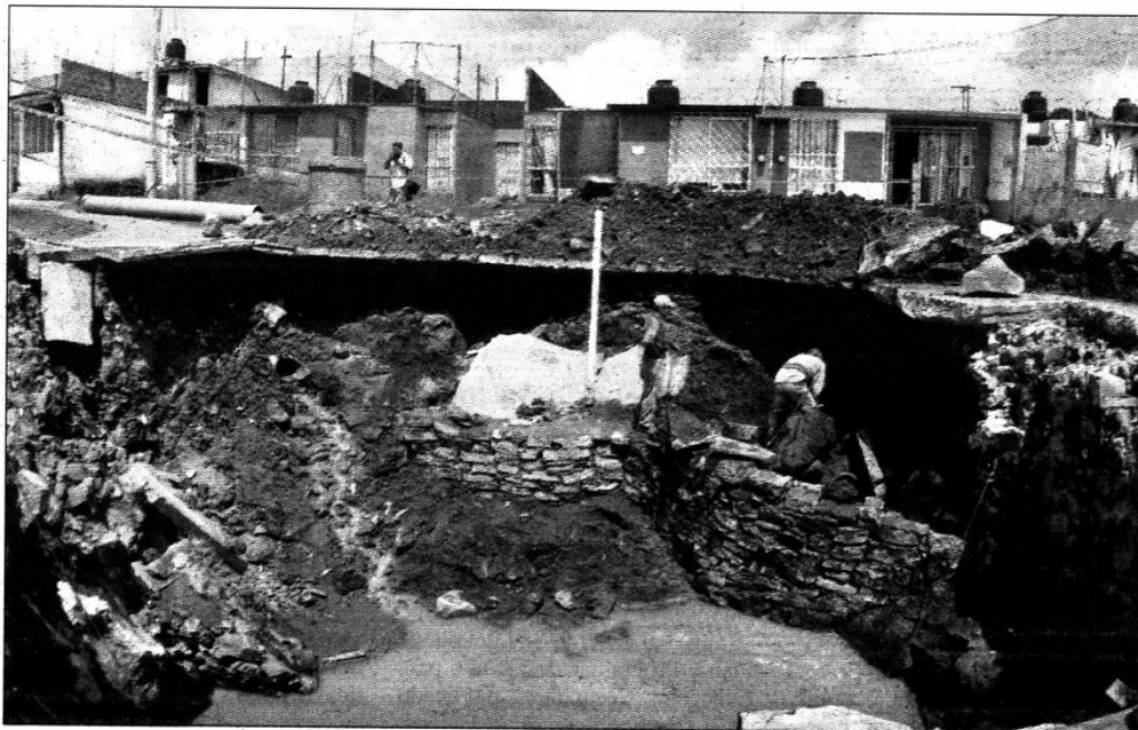
Vecinos de la calle Desierto de Gobi esquina con Desierto de Nubia, colonia Constitución del Sumidero, en Jalapa, Veracruz, temen por su seguridad luego del hundimiento provocado por las lluvias ■ Foto Segio Hernández Vega
