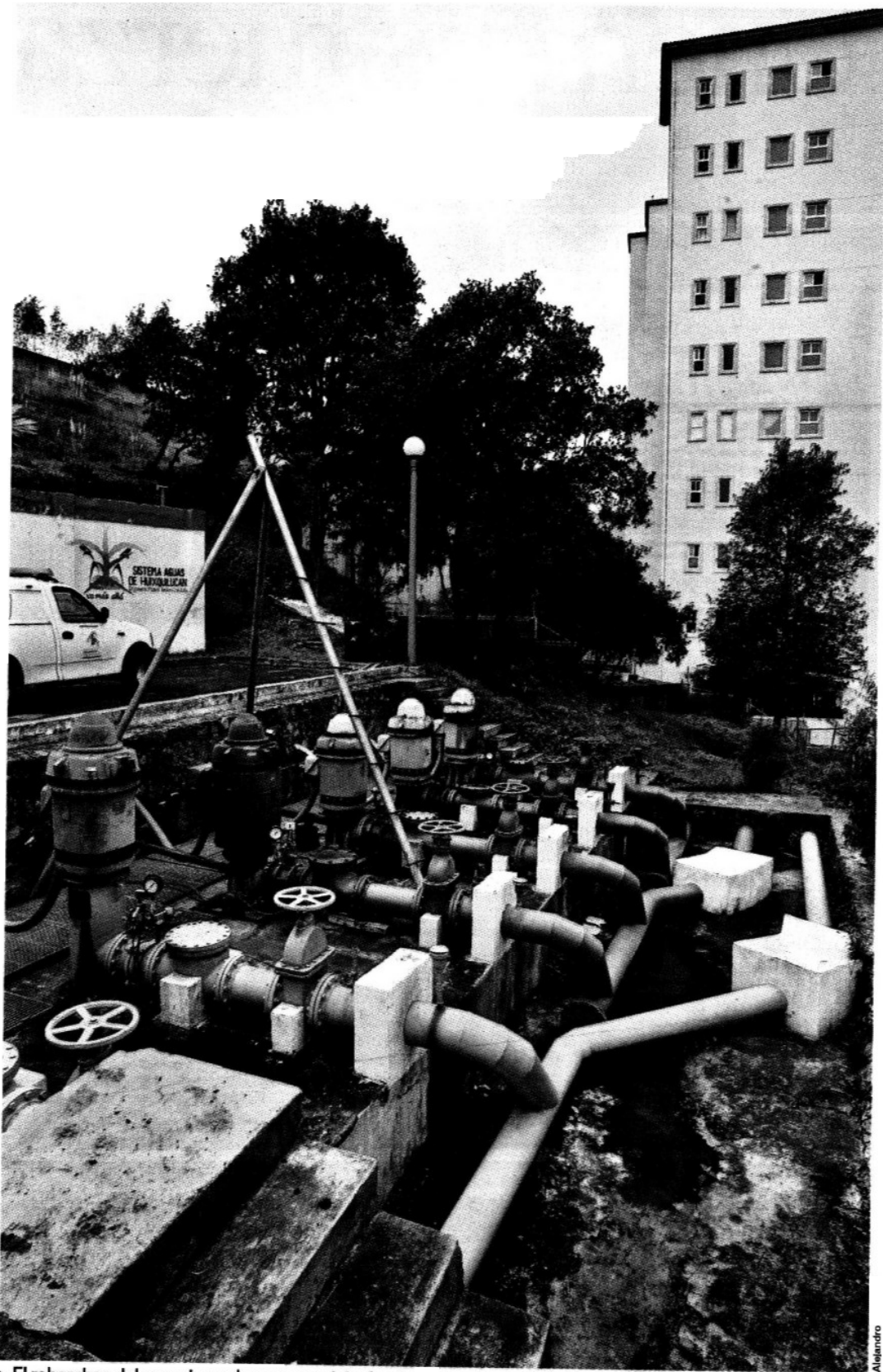
► El rebombeo del organismo de agua municipal se interrumpió por falta de energía eléctrica.
