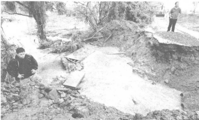
En Veracruz, varias comunidades han quedado incomunicadas debido a que el agua destruyó varios tramos carreteros
