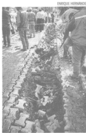
Avenidas tienen fisuras
