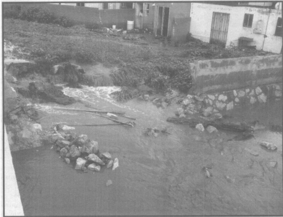
En regiones Otomí-Tepehua y Huasteca reportan 30 derrumbes.
