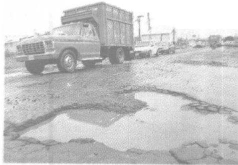
La infraestructura requiere urgentes reparaciones
