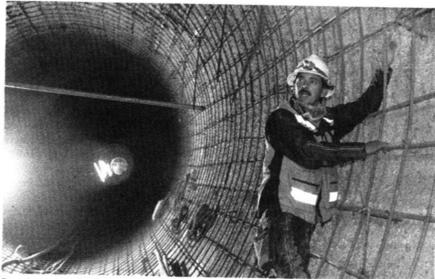
Parte de los 5 mil millones de pesos que se aprobaron se destinarán al mantenimiento del drenaje profundo.
