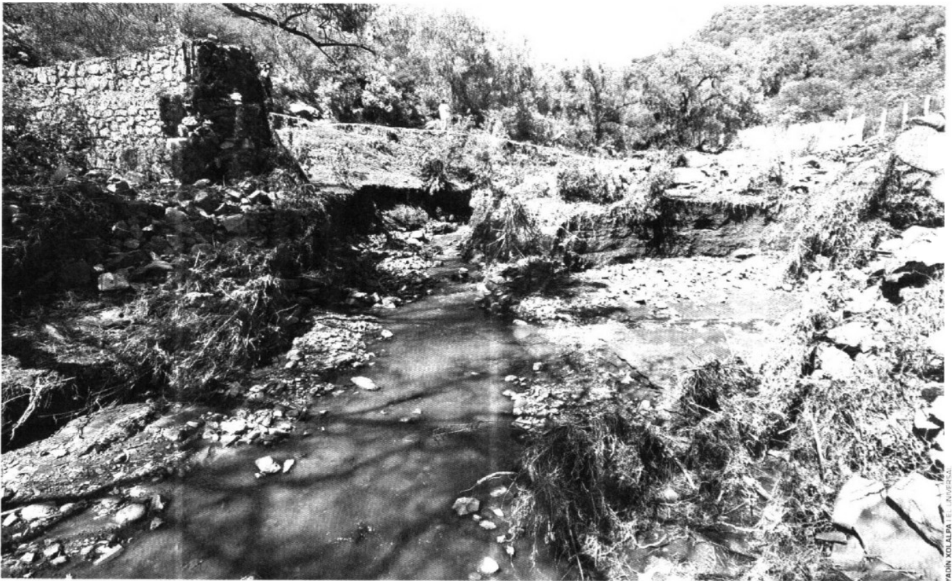
DEVASTACIÓN. Los taludes de piedra y malla de acero instalados en la sierra de Guadalupe no soportaron el empuje del agua. Conagua asegura que los reconstruirá
