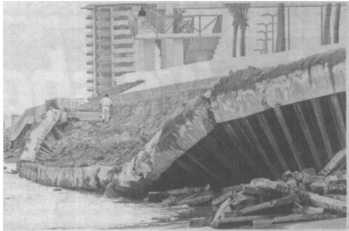
En Boca del Río, el fuerte oleaje ocasionó el derrumbe de una parte de las obras del nuevo boulevard costero. Reportaron vientos de 90 km por hora.
